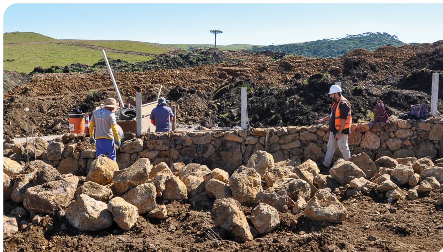
Cercas direcionadoras feitas com taipas para integrar as estruturas à paisagem e garantir durabilidade
