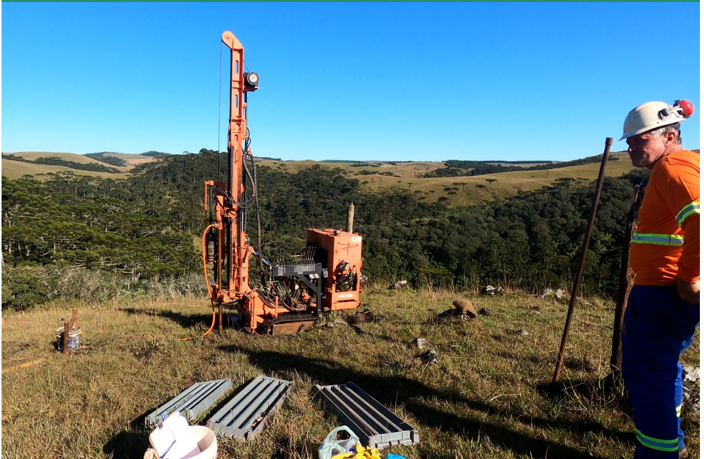
Sondagens de solo permitirão definir a localização dos pilares de sustentação da estrutura que contará com 400 metros de extensão
