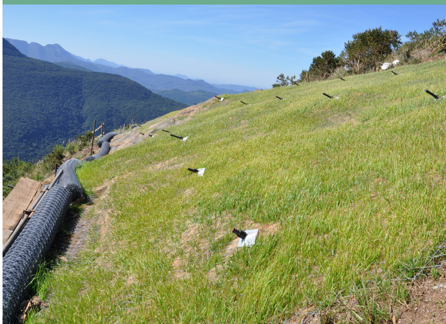
Solo grampeado com faceamento em tela metálica de alta resistência é uma das técnicas utilizadas
