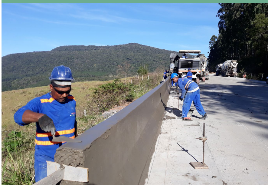
Execução das barreiras New Jersey na Serra da Rocinha, estruturas que visam a segurança dos usuários
