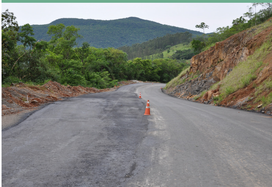
A camada de sub-base tem 10 centímetros de espessura e é feita com concreto compactado a rolo (CCR)
