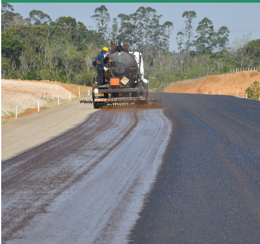
A imprimação é uma espécie de pintura com asfalto diluído que visa proteger o leito já compactado
