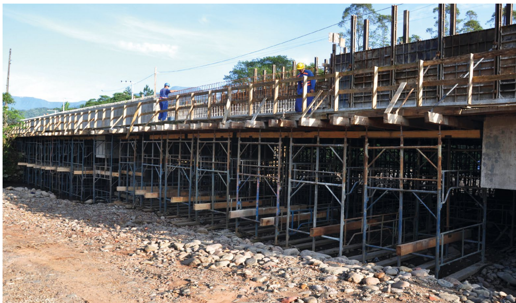
Com 70 metros de comprimento, ponte sobre o rio Rocinha tem previsão de entrega para o final deste ano
