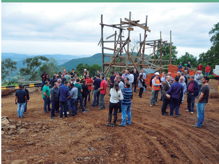
Comitiva de autoridades da região Sul de Santa Catarina vistoriou o andamento das obras em Timbê do Sul
