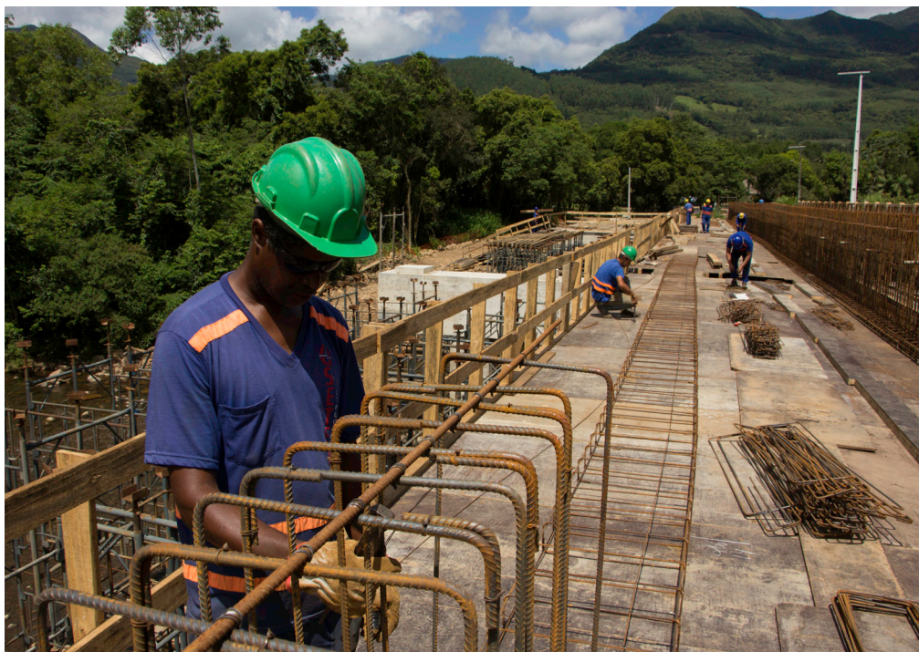
Atividades da etapa de mesoestrutura na ponte sobre o Rio Serra Velha
